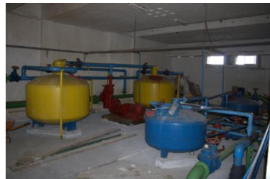
fig. 43 Registro propio de Sala de Filtros. Enero 2024.
