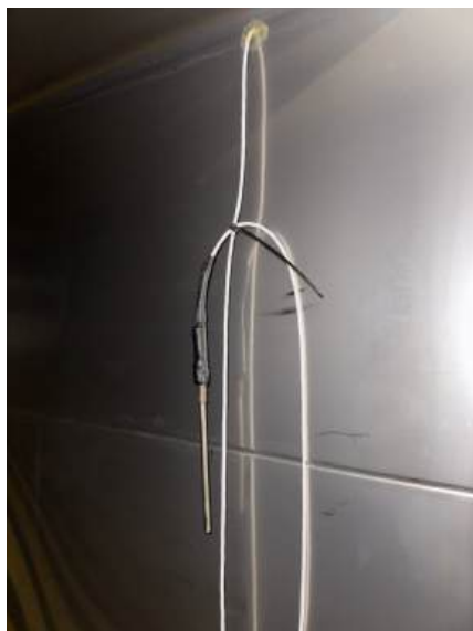
Figura 4.8: Sensor de temperatura (Pt100) integrado en la cámara climática.
