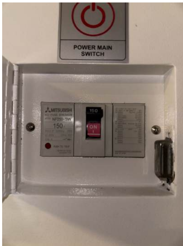
Figura 4.5: Interruptor principal Mitsubishi NF250-SW para alimentación de la cámara.
