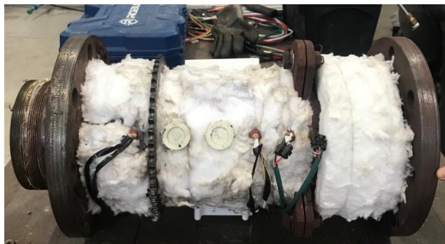
Figura 2.5: Aislación externa del reactor (fuente: propia)
