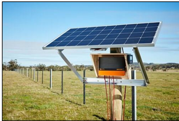
Figura 2- 7: Cerca eléctrica energizada con panel solar
