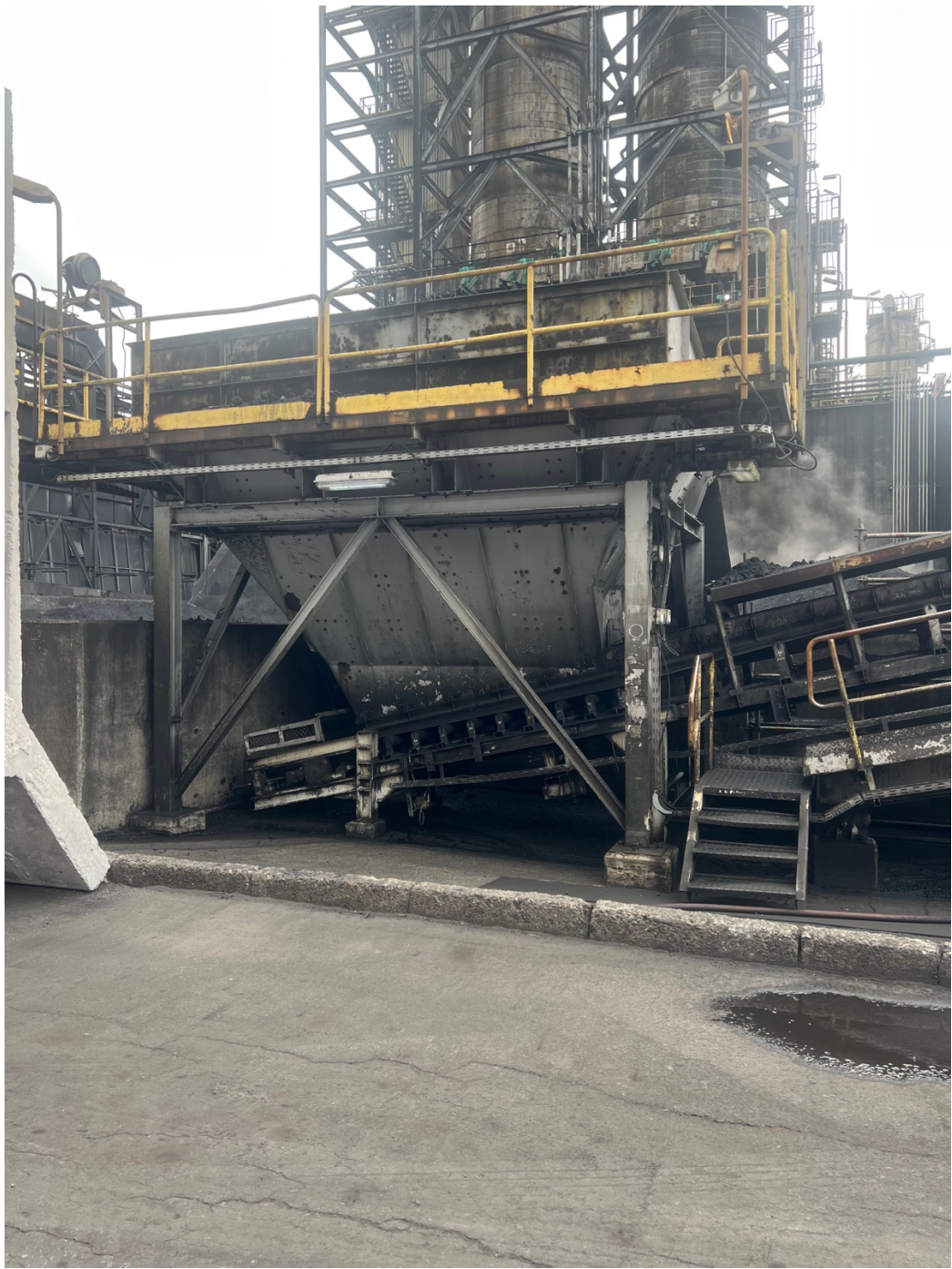
figura - 2-3: Parrilla y tolva de entrada de material de coque.
