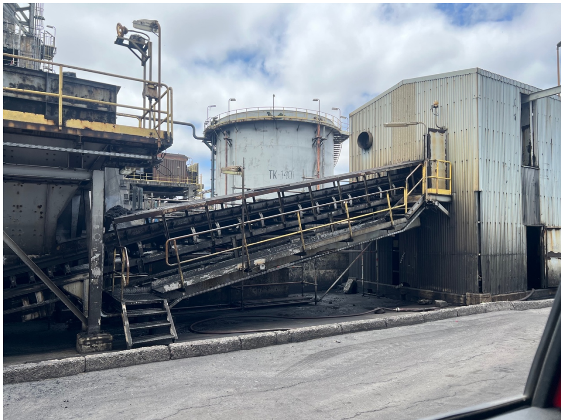
figura - 2-4: Transportador de alimentación del triturador de coque primario.
