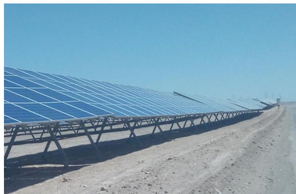
Ilustración 14: Estructura soportante inadecuada
