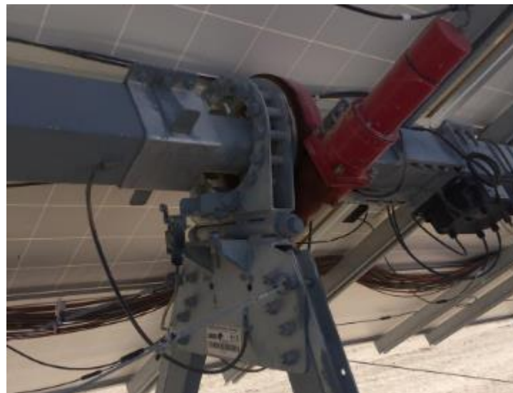
Ilustración 12: Cableado sin abrazaderas
