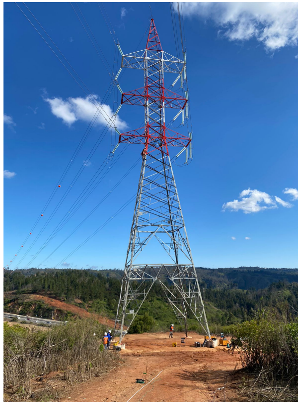
Figura 19: Torre de transmisión PAS-27 La Pólvora – Agua Santa 220 [kV]
