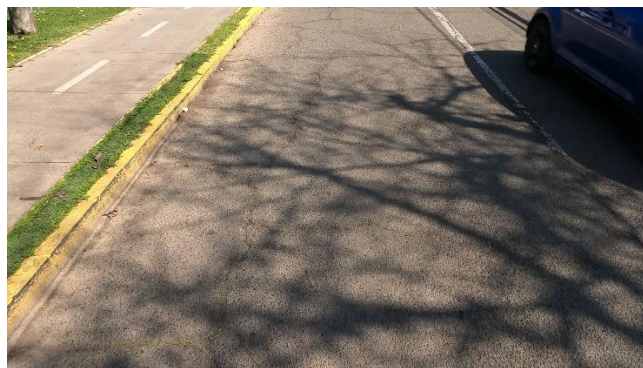
Figura 12: Imagen de pavimento con sombras y grietas.
