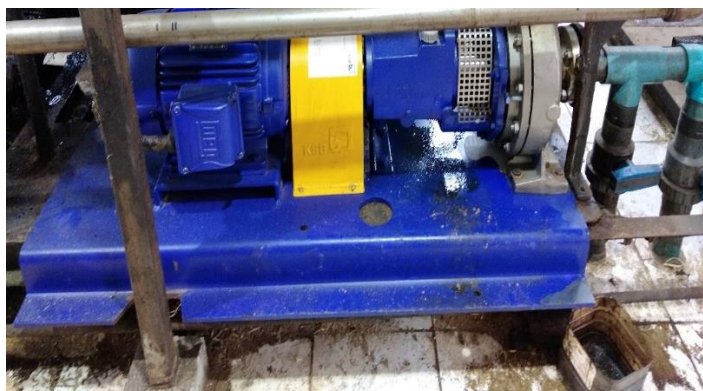
Figura 2-3 Bomba de Agua
