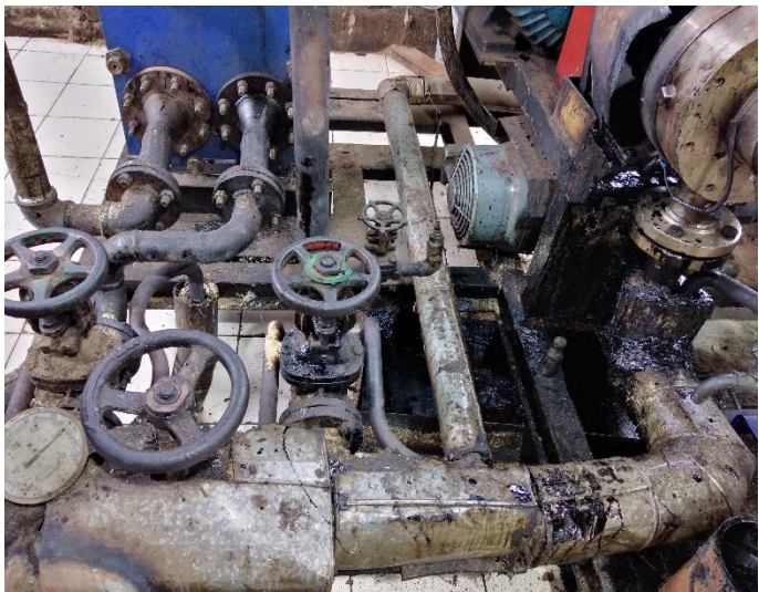
Figura 2-4 Cañerías MC2 Fuente: Elaboración propia
