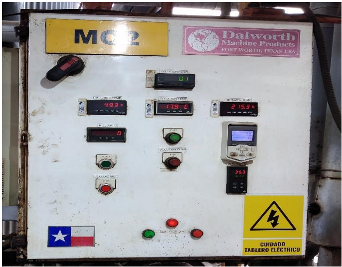
Figura 2-5 Tablero eléctrico Fuente: Elaborarion propia
