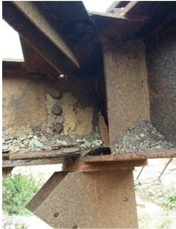
Figura 60: Estado de elementos en encuentro de vigas, pilar y diagonal.
