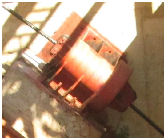
Figura 48: Lugar donde se encuentra el sistema de acñamiento del sistema de seguridad.
