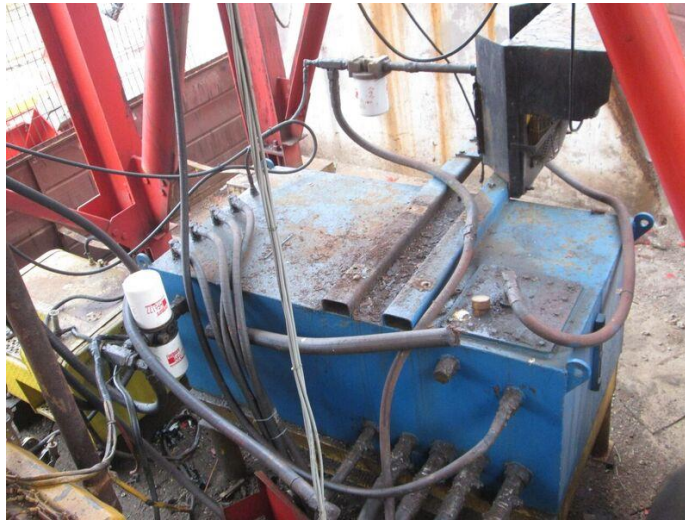
Figura 54: ausencia de componentes y mangueras rotas e inexistentes.
