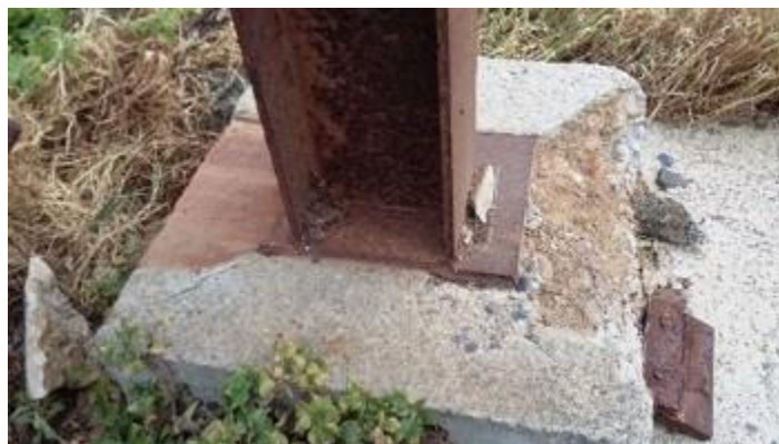
Figura 62: Estado general de fundaciones.
