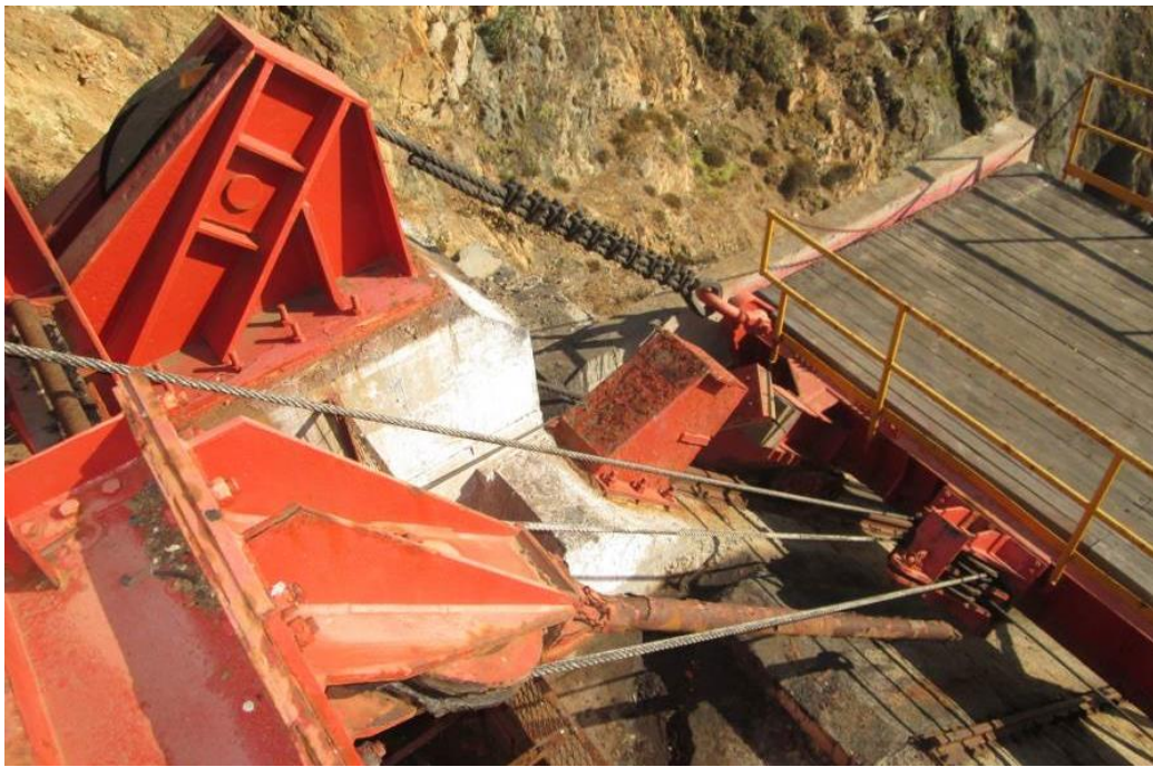
Figura 21: Poleas horizontales de desvío en carro y estructura superior.
