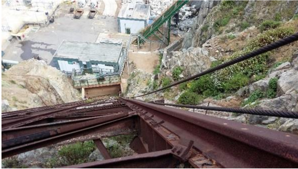
Figura 57: Vista de la pérdida de linealidad del riel.
