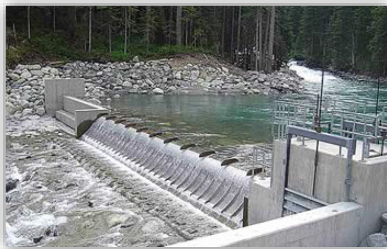
Ilustración 3: Captación de río con rejillas autolimpiantes.
