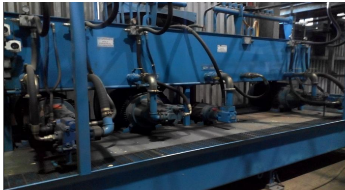
Figura 1-15 Unidad hidráulica (Fuente: fotografía propia)
