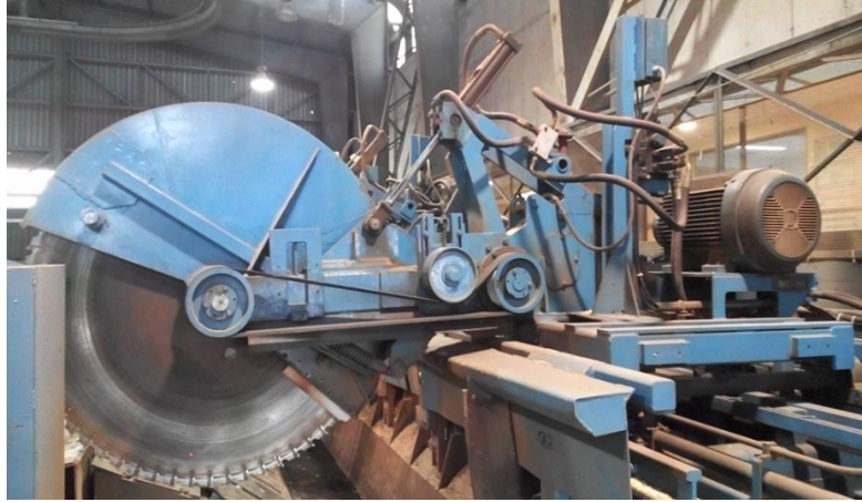
Figura 1-22 Módulos de sierras (Fuente: fotografía propia)
