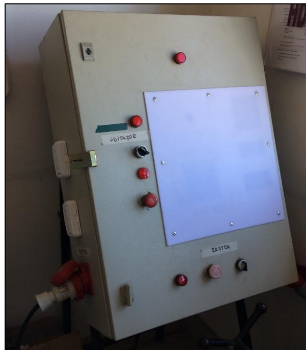
Figura 58. Tablero eléctrico para manipular rastra mecánica y agitador.
