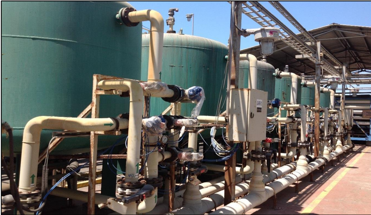
Figura 72: Batería de filtros de arena de la planta de RILes Puerto Collahuasi.
