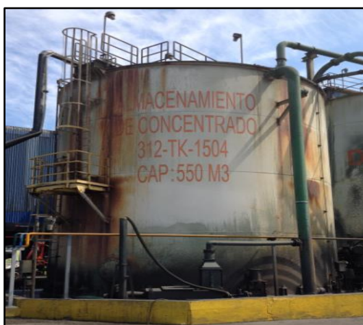
Figura 20: Tanque almacenador (312-TK-1504) de CUCON.
