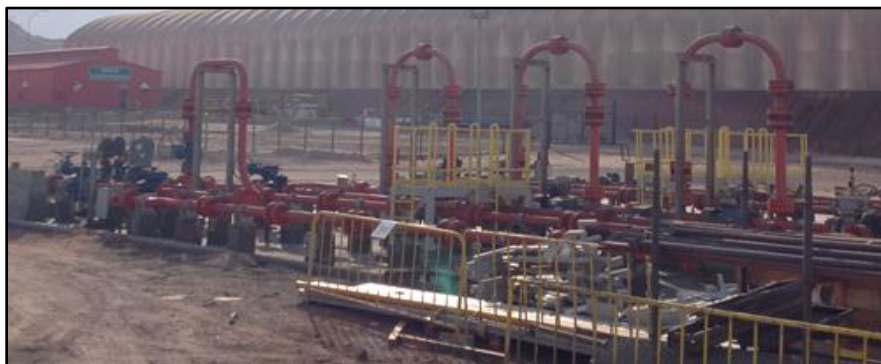
Figura 19: Concentroductos en área Puerto.
