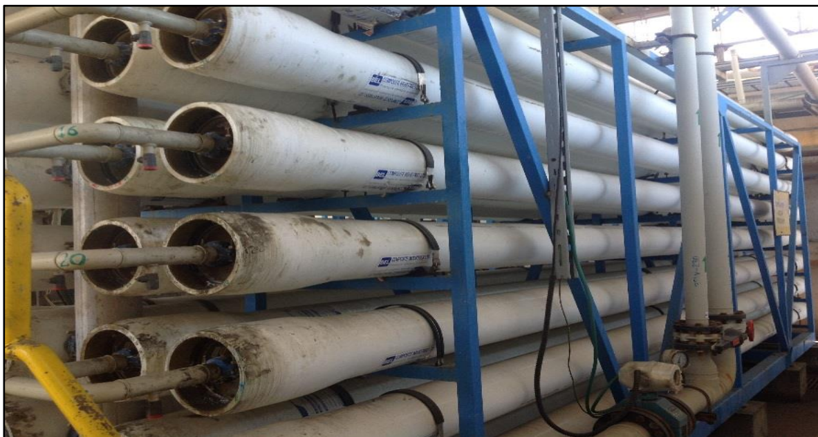
Figura 75: Módulo OR de la planta de tratamiento de RILes Puerto Collahuasi.
