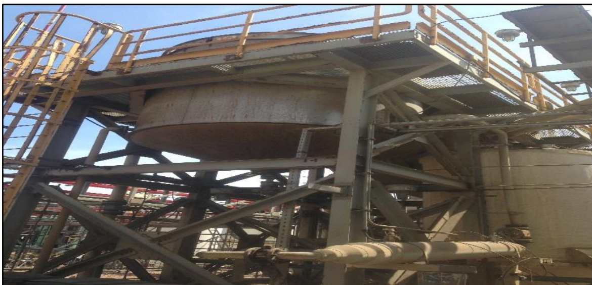
Figura 71: Celda de flotación por aire disuelto de la planta de RILes Puerto Collahuasi.
