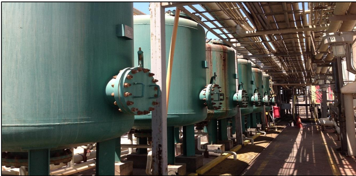
Figura 73: Batería de filtros de carbón activado de la planta de RILes Puerto Collahuasi.
