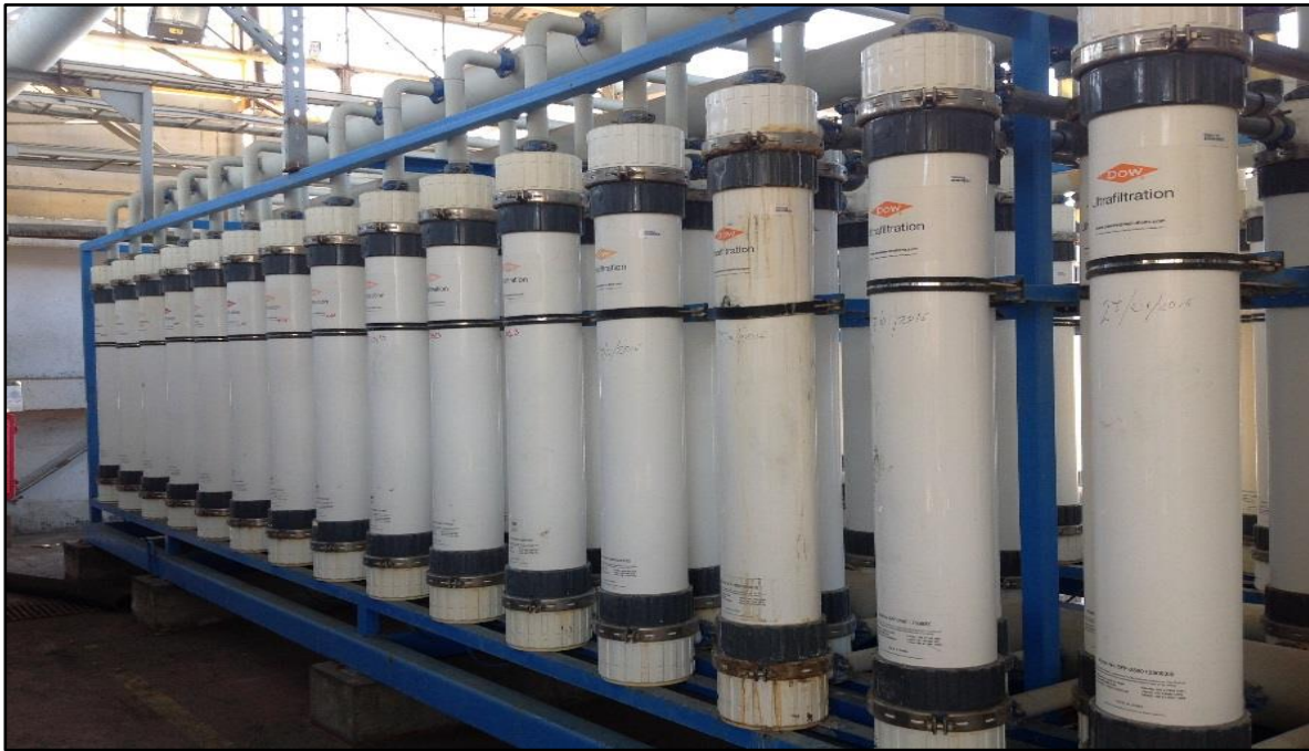
Figura 74: Módulos UF de la planta de tratamiento de RILes Puerto Collahuasi.
