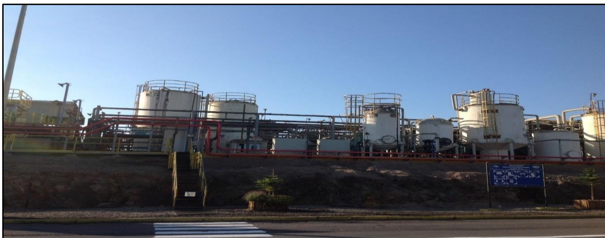
Figura 23: Planta de tratamiento de RILes.
