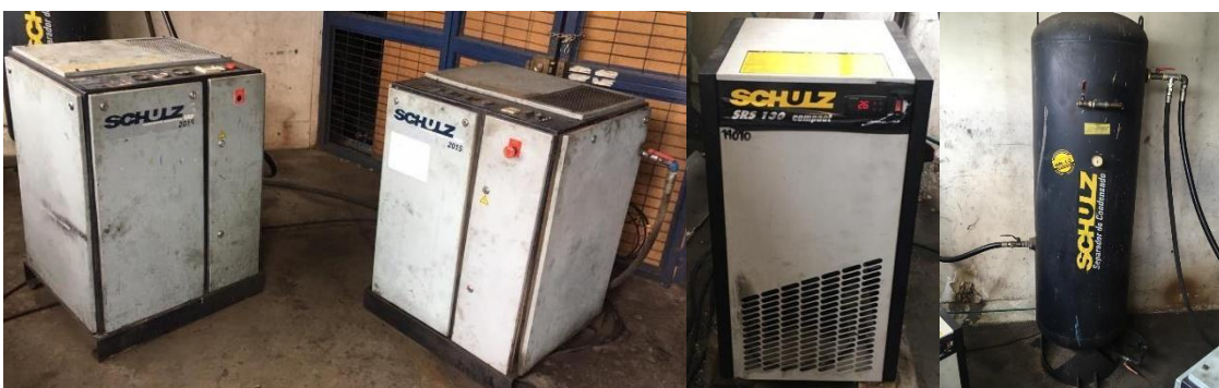
Figura 2. Equipos sala de compresores Zona D, Express de Santiago Uno. Fuente: Recopilación de imágenes propias.
