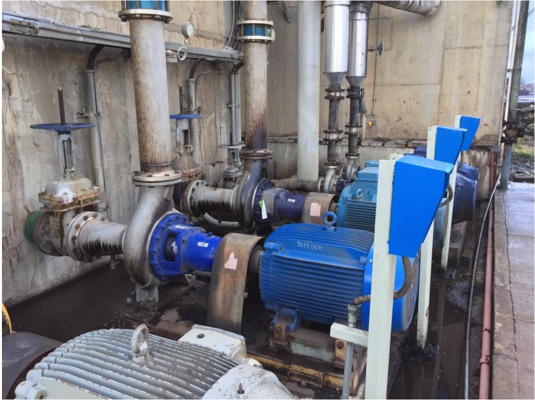
Imagen 32: Bomba centrífuga KSB KWPK 200-200-0403 DUUD10 Fuente: propia
