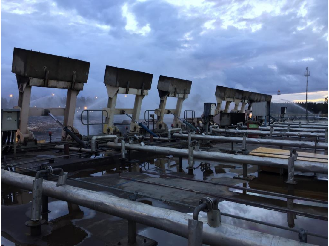
Imagen 28: vista posterior de compuerta de cámaras de macerado. Fuente: propia
