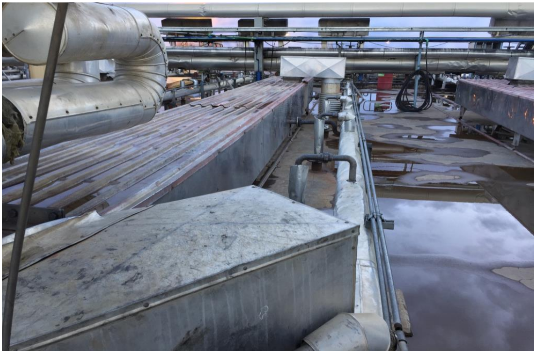
Imagen 29: Tinas para generar vapor median condensado. Fuente: propia
