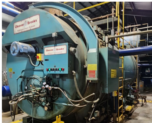
Figura 25. Caldera. Fuente: Elaboración Propia.
