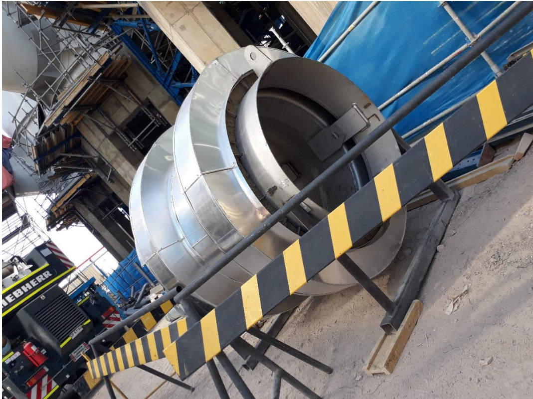
Figura 2-12. Levantamiento Línea 4014, Ducto con junta de expansión
