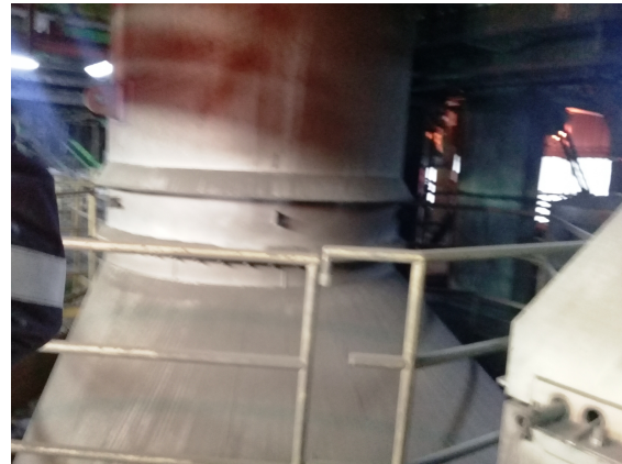
(b) Ventilador descarga 08-VEN-040.
