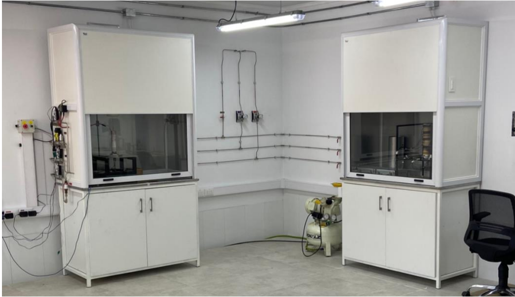
Figura 10: Fotografía de las campanas del laboratorio
