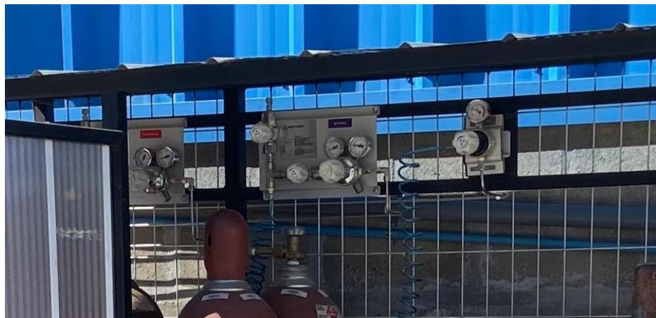
Figura 12: Válvulas de control exteriores
