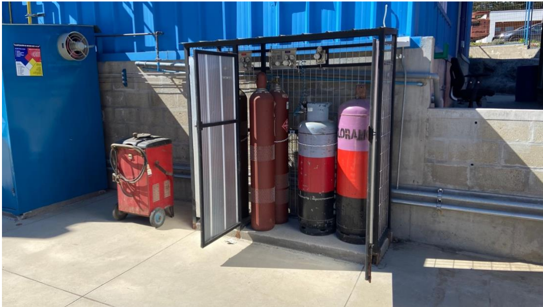
Figura 11: Caseta para guardar gases combustibles
