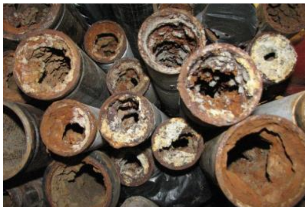
Figura 16. Ejemplo de ensuciamiento por corrosión en tubos de intercambiadores de calor. (Thermopedia, 2011)
