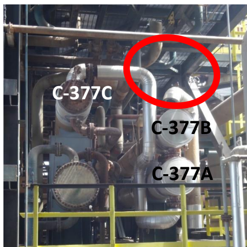
Figura 37. Intercambiadores de calor C-377 A/B/C en la unidad de Reformación.
