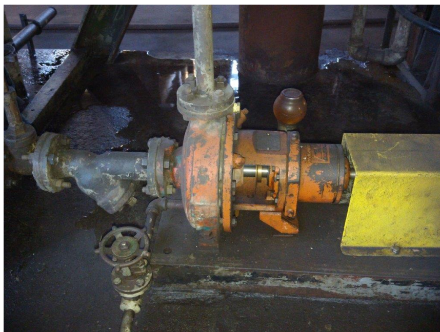
Figura 31. Bomba Centrífuga J-382 A, no posee instalación de plan API 11 - 13.
