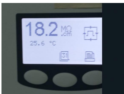
Figura 21. Panel del equipo de ultrafiltración indicando conductividad y temperatura del agua filtrada.
