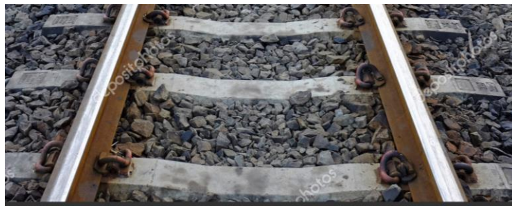
Foto 3-15: Fijaciones Pandrol en durmientes de hormigón pretensado.
