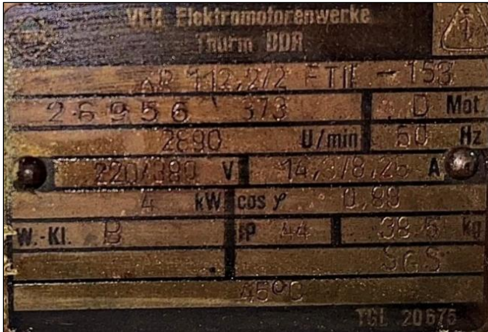
Figura 11 - Placa del motor eléctrico.
