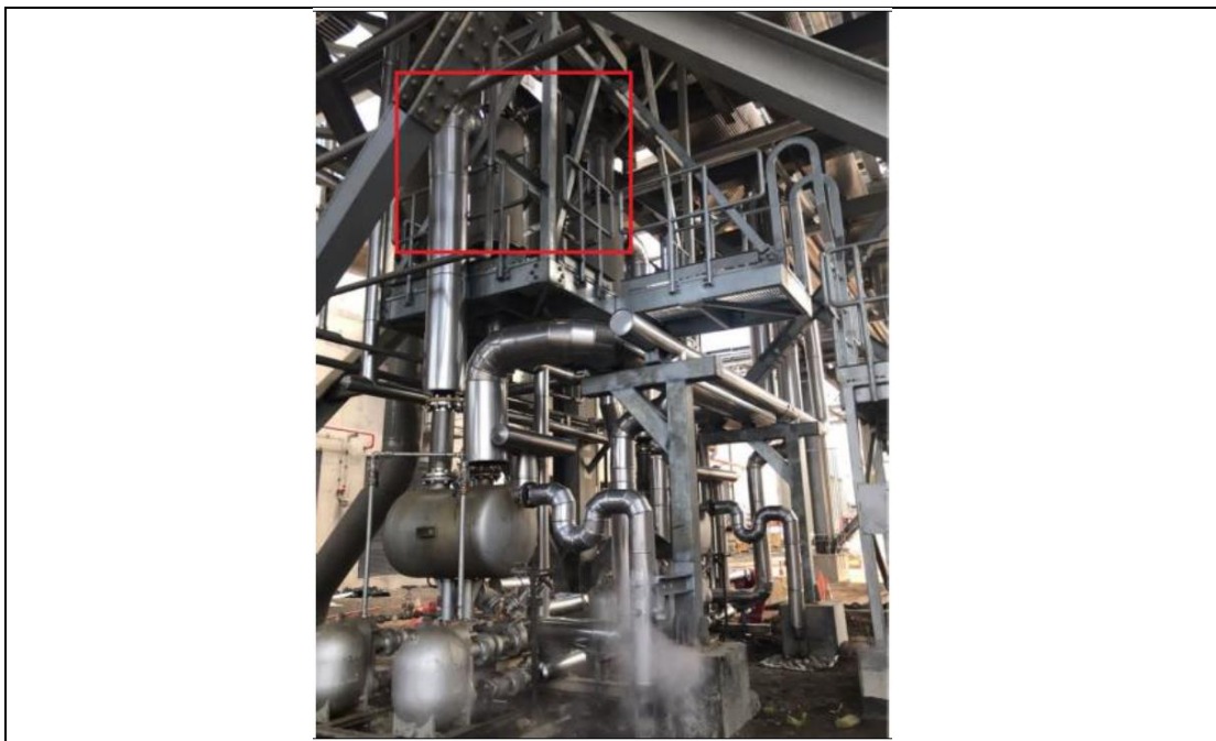
Figura 4: Sistema de recuperación de calor de vapor flash y sistema dual de bombas GP10 de TLV instaladas en planta de celulosa en Chile (equipo SR en cuadro rojo)
