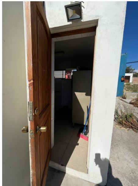
Figura 24: Estado actual entrada al baño
