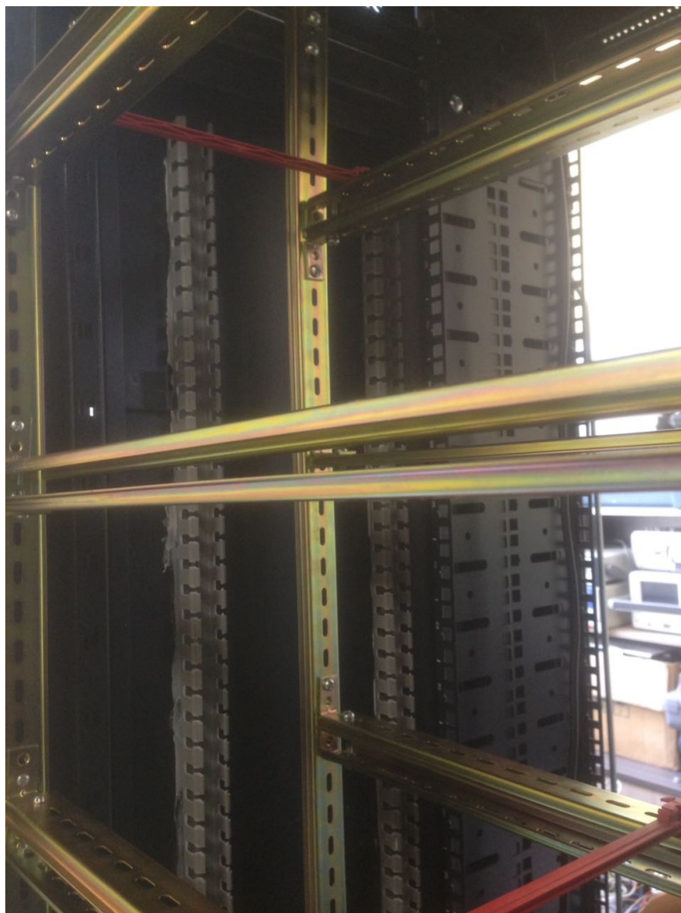
Figura 6.6: Canalización para fibra y potencia
