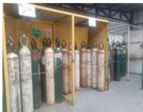
Figura 1: Almacenamiento de gases comprimidos
