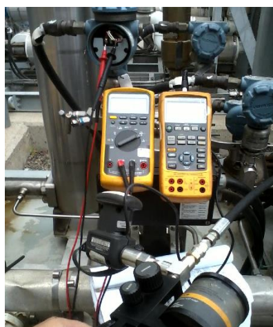
Fuente: Cámara personal, Central Colmito
