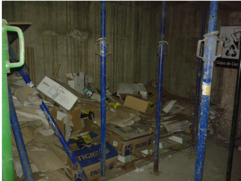
Figura 5.7-2 Desorden en la Zona de reciclaje
