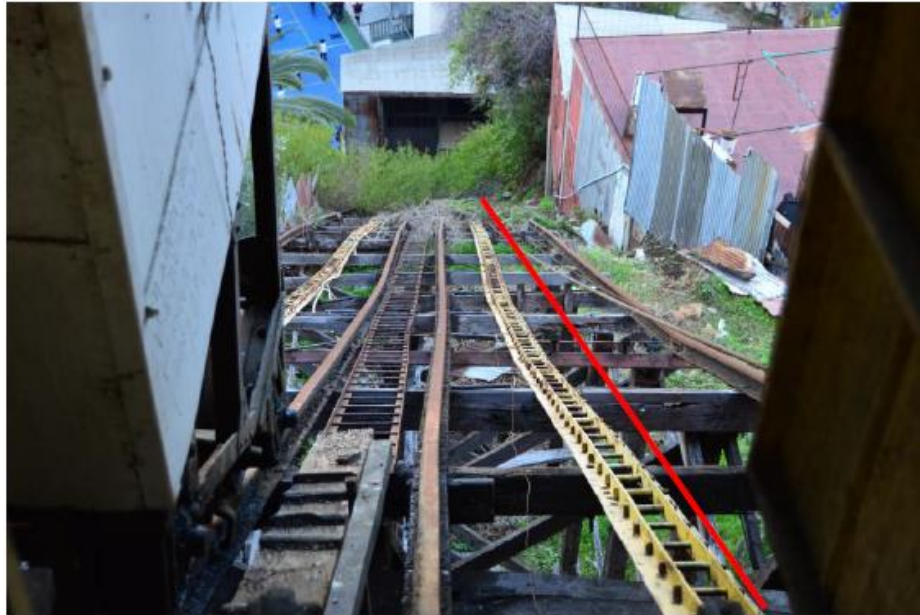
Figura 3.1 Estado componentes del plano de rodadura, Ascensor Larraín (14)
