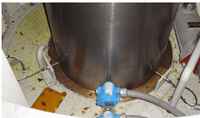
Figura 34. Sensores de vibración relativa de los rodamientos de la turbina.
