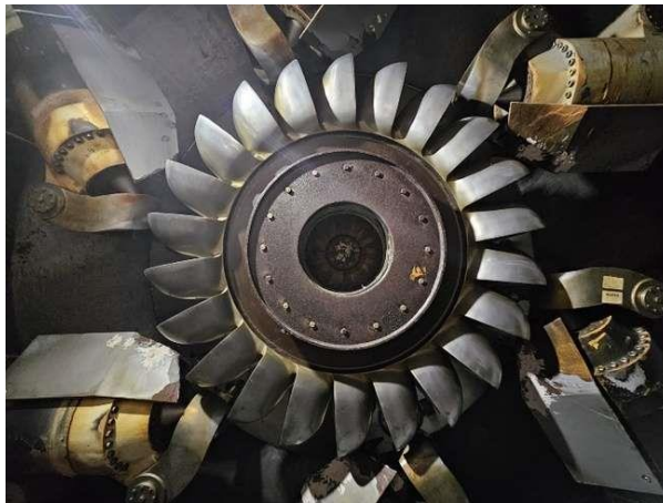
Anexo 2. Rodete de 22 cangilones de central Blanco.
