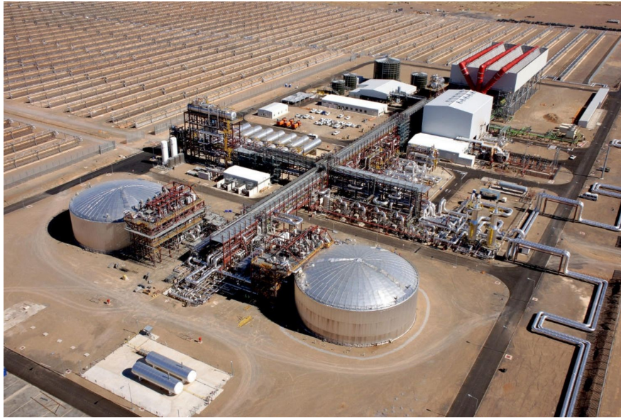
Figura 5.3: Tanques de Central Termosolar Kaxu Solar One ubicada en Sudáfrica. (Abengoa, 2021 )
