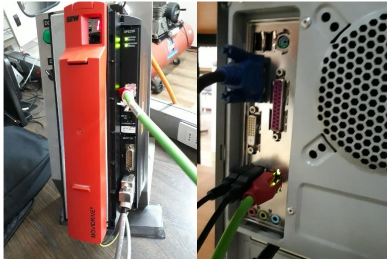
Imagen 1, 1 Conexión ethernet Pc-Servomotor.
