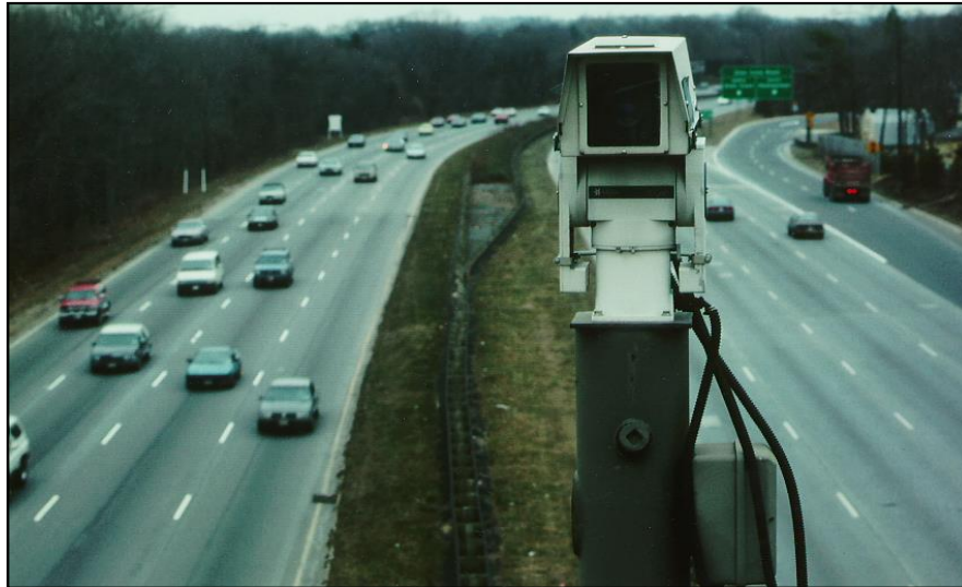
Figura N° 18 Cámara de monitoreo en la faja central de la ruta
