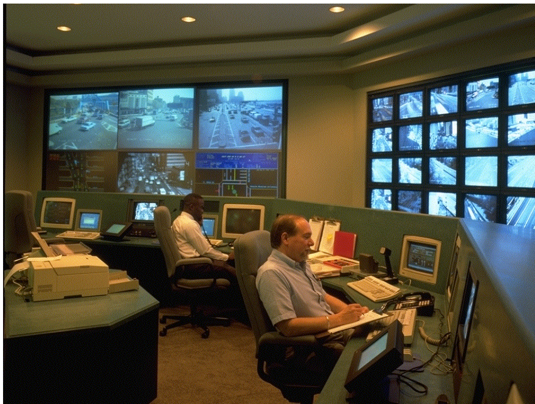
Figura N° 16 Sala de Control Tipo
