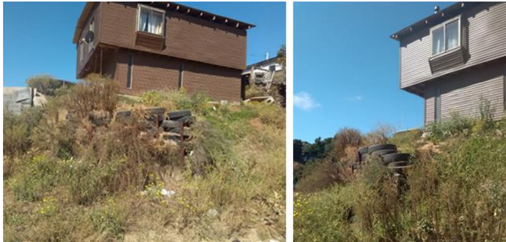
Figura 4-23 Elemento de contención: Falla por volcamiento. Achupallas.
