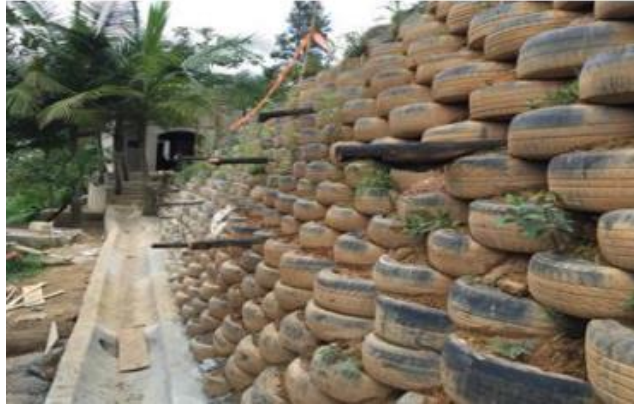
Figura 4-13 Barbacanas de PVC y cuneta de hormigón en muros de contención con NFU. Extraído de (Rodríguez, O., 2016).
