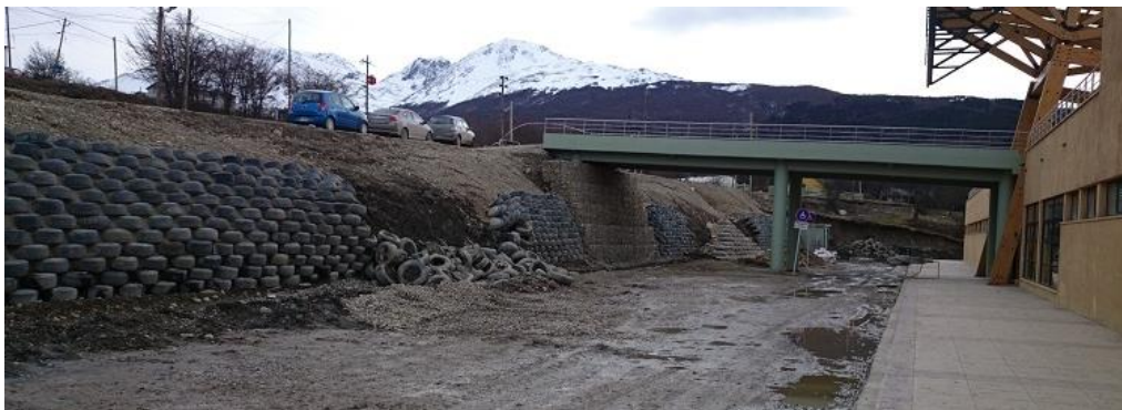
Figura 4-11 Colapso de muro por aumento de presiones hidrostáticas. Obtenido de (94diez.com, 2014).
