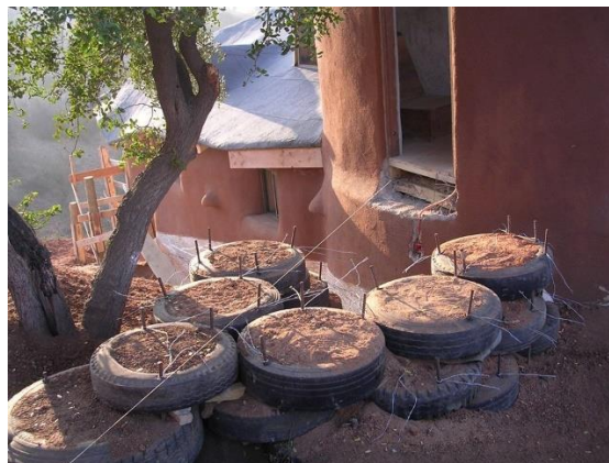
Figura 4-20 Muro de neumáticos al tresbolillo con refuerzo al corte. Cortesía de Marcelo Witto Mättig.
