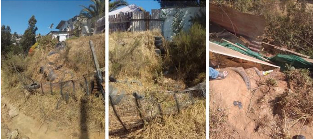
Figura 4-22 Izquierda y centro: Refuerzo de suelo artesanal que falló; Derecha: Refuerzo de suelo artesanal aún vigente. Achupallas.
