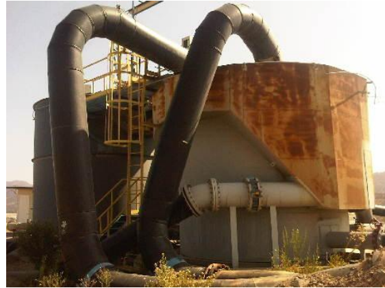
Figura 1.25, Descarga bombas RABI 705msnm
