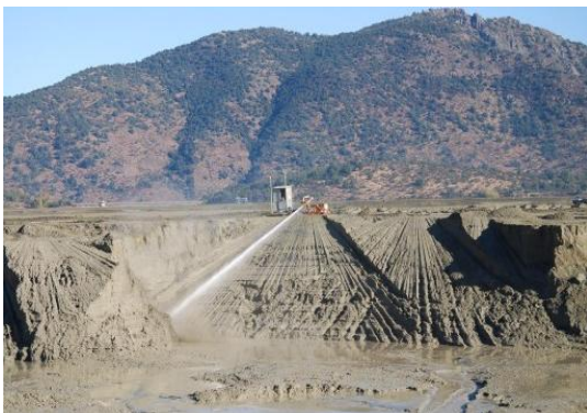
Figura 1.4, Generación de relave
