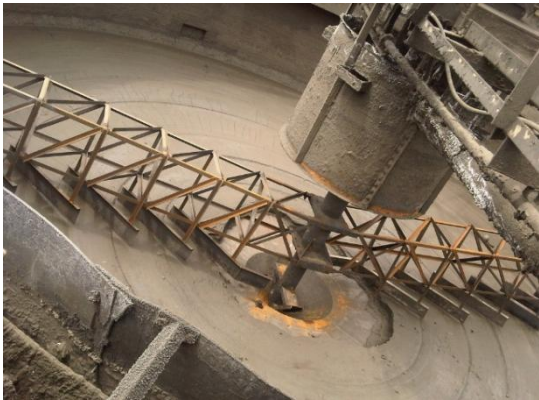
Figura 1.16, Espesador mixto, acumulador planta flotación selectiva
