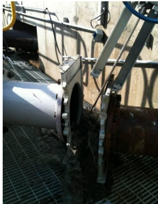
Figura 2.2, Colapso de válvula guillotina línea de descarga bomba RABI 1
