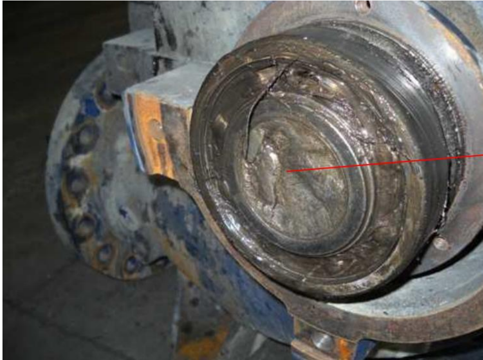
Figura 2.3, Corte de eje en bomba instalada en posición RABI 6
