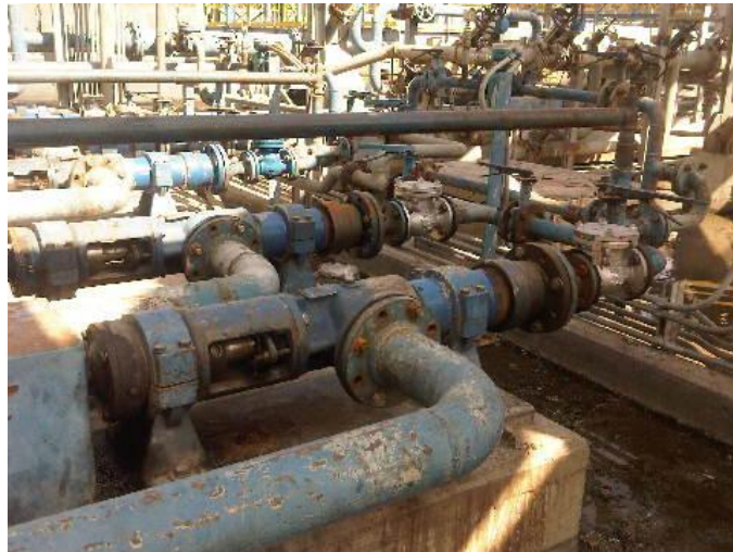
Figura 1.23, Bombas cavidad progresiva alimentación floculante a espesadores de relave.
