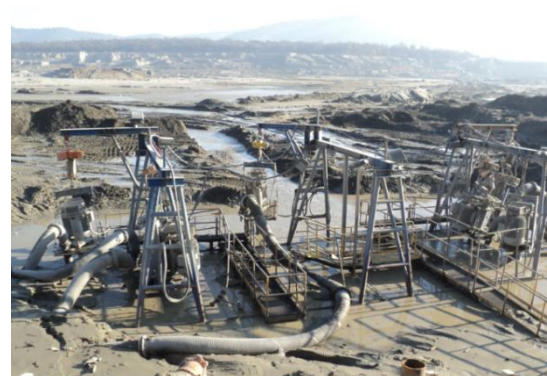
Figura 1.5, Sumidero, sector impulsión hacia planta de proceso.
