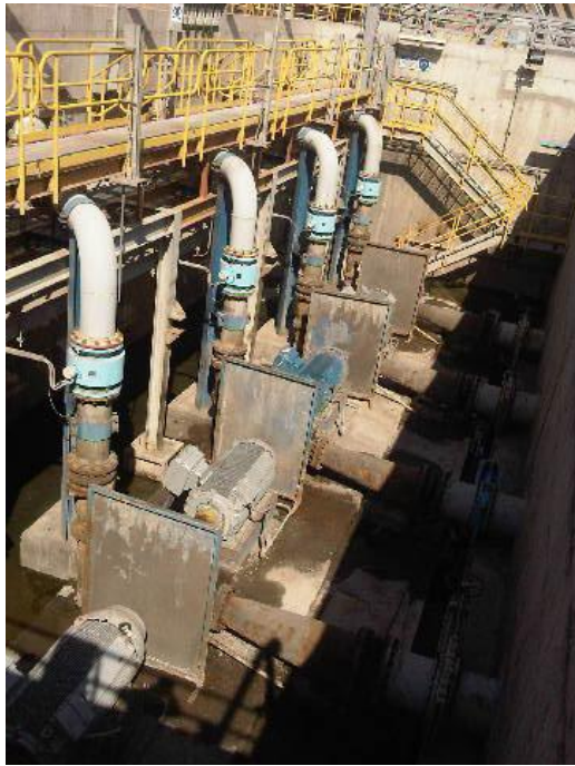
Figura 1.26, Sala de bombas RABI 595msnm
