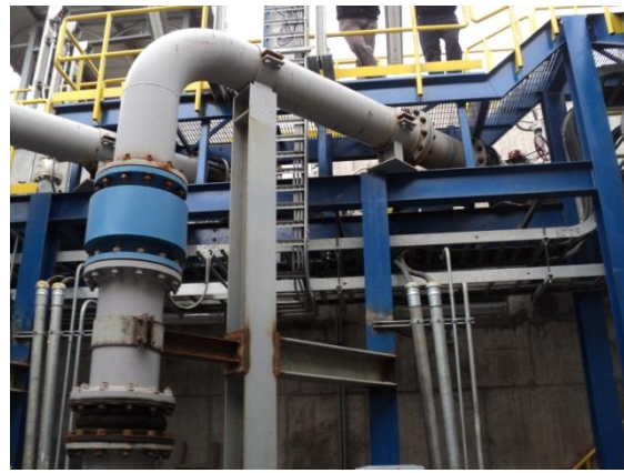
Figura 1.28, Línea descarga bomba RABI
