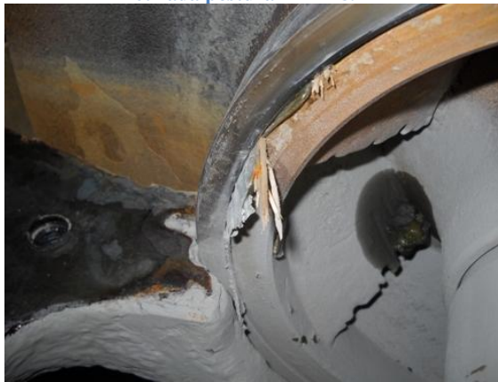
Detalle de residuos presentes entre anillos de desgaste bomba retirada postura RABI 8.
