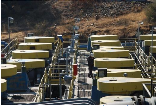
Figura 1.14, Celdas OK38 1500 ft 3 (42,5 m 3 ), bancos 1ra limpieza
