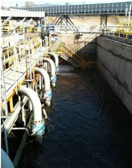
Figura 2.1, Sala de bombas N°1 posterior al colapso válvula guillotina línea de descarga bomba RABI 1
