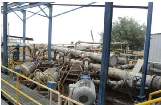
Figura 1.2, Estación de Bombas de alta
