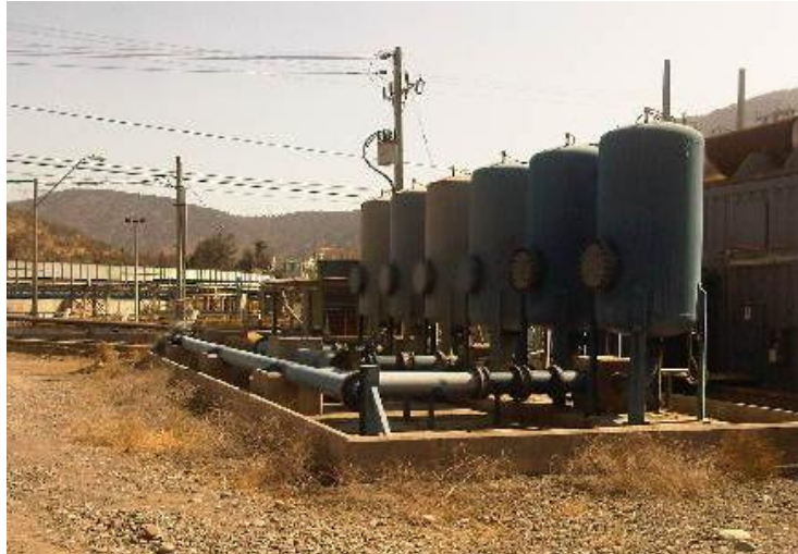
Figura 1.29, Estación golpe de ariete
