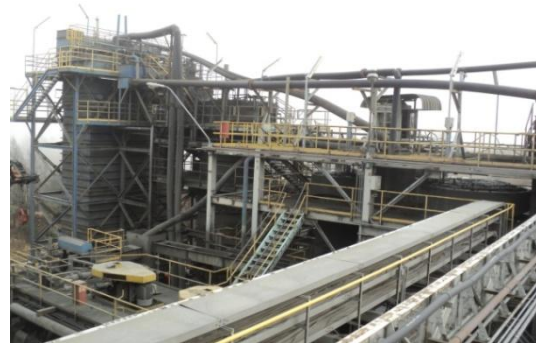
Figura 1.15, Columnas de flotación, 2da a 4ta limpieza
