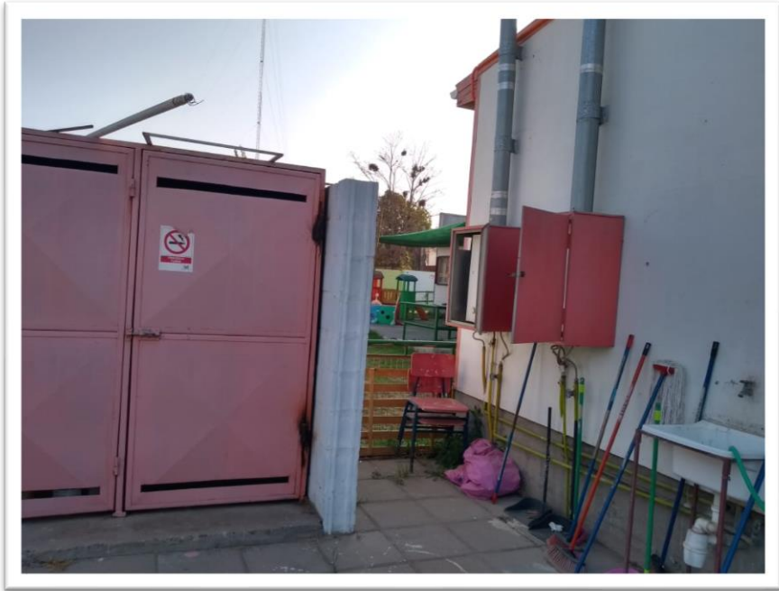
Fuente: Elaboración propia. Figura 1-16. Lugar de los calefón y almacenamiento de cilindros de gas.
