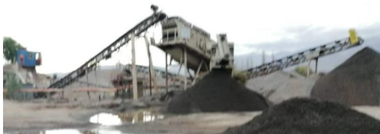
Figura 3-4. Planta de arena fina.
