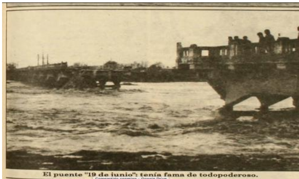
Figura 2-2. Daños puente 19 de Junio Calera con Artificio en el año 1987
