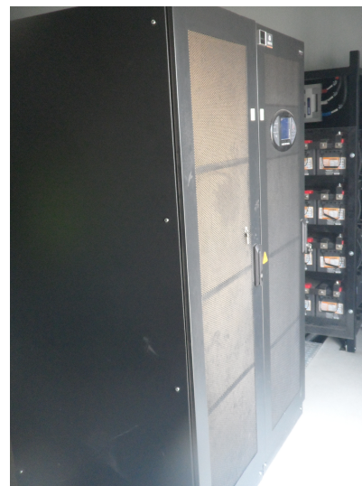
(b) UPS N°2 Liebert NX 250 kVA
