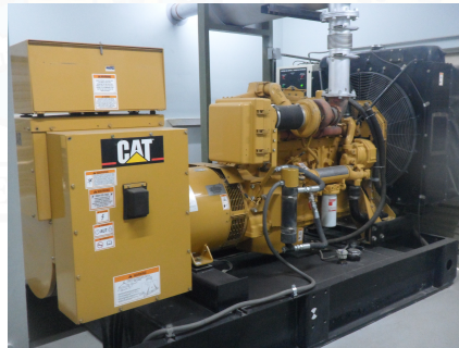
Figura 3.9: Grupo Electróno Caterpillar Subestación Eléctrica Remota (Fuente: Dirección General de Aeronáutica Civil, 2019)
