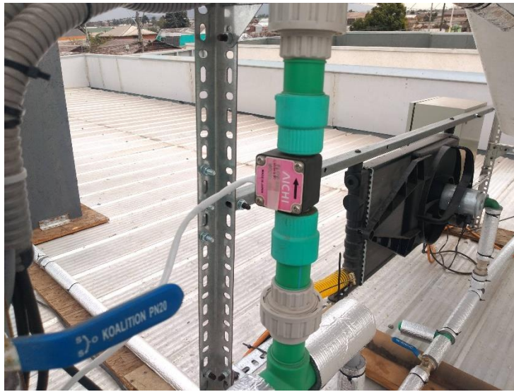
Figura 5.16. Caudalímetro en su ubicación final.
