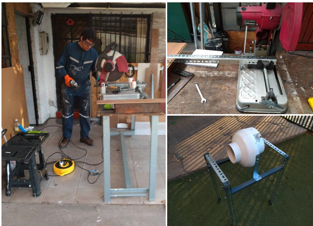
Figura 4.5. Izquierda, construcción de estructuras. Derecha arriba, esmeril de banco utilizado para los cortes. Derecha abajo, estructura del ventilador terminada.
