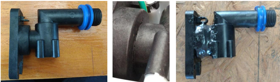
Figura 4.17. Reparación de calentador de agua. Izquierda, sensor de flujo antes de ser reparado. Centro, fisura en el conducto. Derecha, conducto luego de la reparación.
