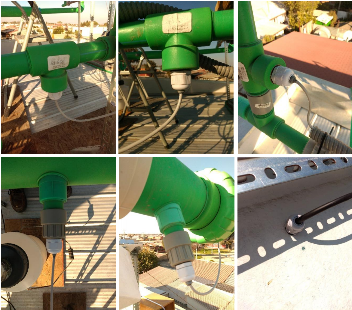
Figura 5.10. Instalación de termómetros en desalinizador HDH.
