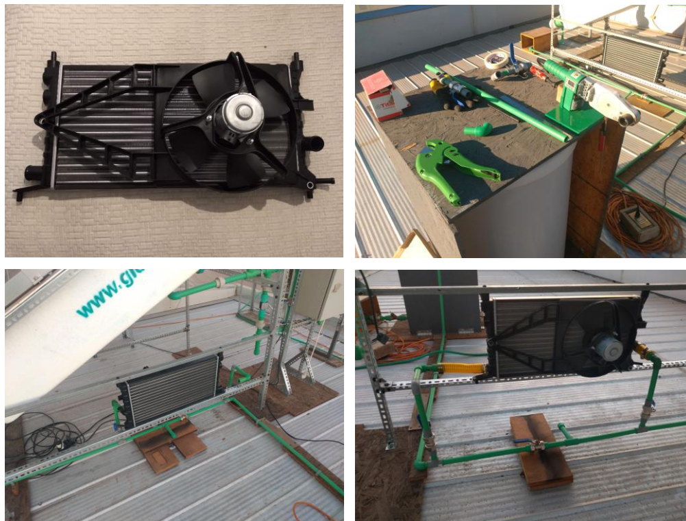
Figura 6.1. Enfriador de agua. Arriba, equipo antes de instalar y estación de trabajo. Abajo, intercambiador instalado visto desde el frente y atrás.
