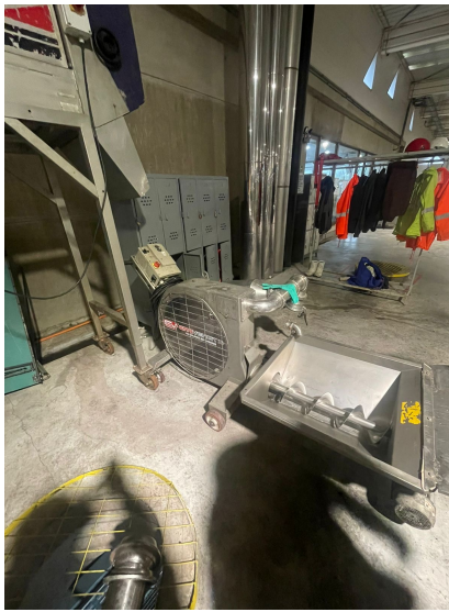
(b) Bomba de masa móvil utilizada en varias líneas.
