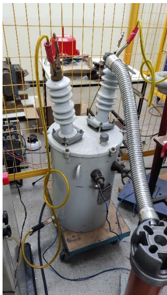
Figura 4 Transformador de alta tensión usado (Fuente: propia)
