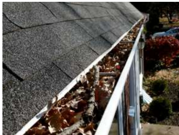
Figura N°20 Evidencias canaletas tapadas por hojas secas (material combustible).
