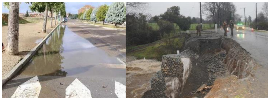
Ilustración 23. Ejemplo de agua en la calzada (izquierda) y socavón (derecha). (Arriagada y Echaveguren; Manual de Inspección Visual de Activos de Saneamiento y Drenaje de Carreteras).
