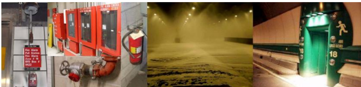
Ilustración 11. Equipamiento de protección contra incendios y acceso a rutas de escape. (FHWA; Manual de Operación, Inspección, Mantenimiento y Evaluación en Túneles)
