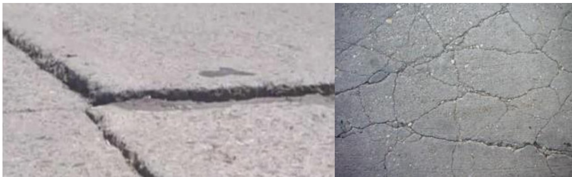
Ilustración 24. Ejemplo de escalonamiento en baden (izquierda) y grietas en cuneta revestida (derecha). (Arriagada y Echaveguren; Manual de Inspección Visual de Activos de Saneamiento y Drenaje de Carreteras).
