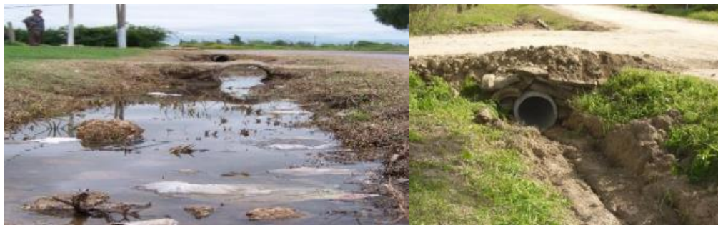
Ilustración 30. Ejemplo de discontinuidad en cuneta revestida (izquierda) y socavación en alcantarilla sin muro de boca (derecha).
