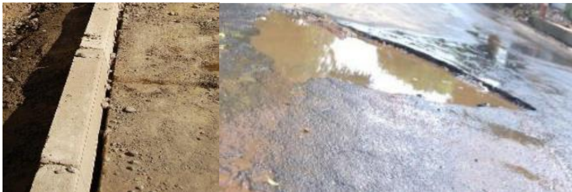
Ilustración 28. Ejemplo de desplazamiento en solera (izquierda) y bache en baden (derecha). (Arriagada y Echaveguren; Manual de Inspección Visual de Activos de Saneamiento y Drenaje de Carreteras).
