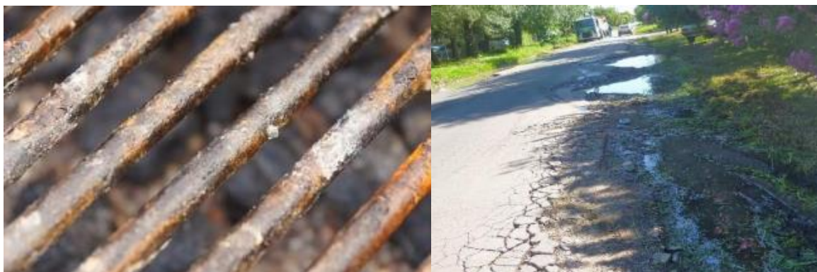
Ilustración 29. Ejemplo de oxidación en sumidero (izquierda) y separación de la cuneta (derecha). (Arriagada y Echaveguren; Manual de Inspección Visual de Activos de Saneamiento y Drenaje de Carreteras).
