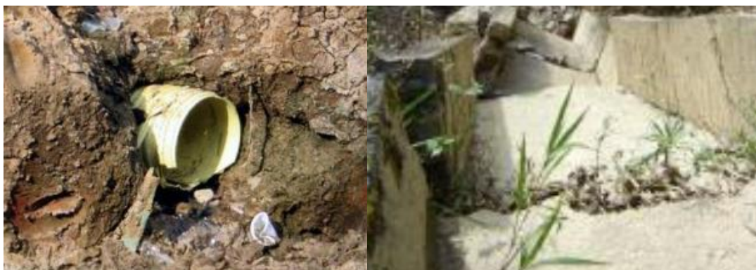
Ilustración 25. Ejemplo de abrasión en alcantarilla sin muro de boca (izquierda) y fracturamiento estructural en colectores (derecha). (Arriagada y Echaveguren; Manual de Inspección Visual de Activos de Saneamiento y Drenaje de Carreteras).
