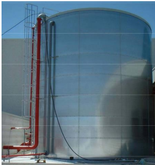
Ilustración 2. Estanques con reserva de agua para cortinas de agua en caso de incendio. (Pefipresa 2015, sistemas de protección contra incendios en Túneles).
