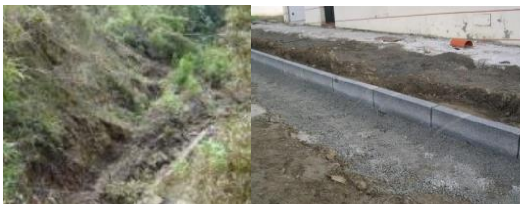
Ilustración 27. Ejemplo de deslizamiento en colector (izquierda) y asentamiento en soleras (derecha). (Arriagada y Echaveguren; Manual de Inspección Visual de Activos de Saneamiento y Drenaje de Carreteras).
