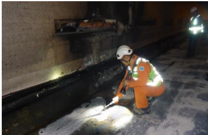
Ilustración 13. Evaluación del daño provocado posterior a un incendio. (FHWA; Manual de Operación, Inspección, Mantenimiento y Evaluación en Túneles)
