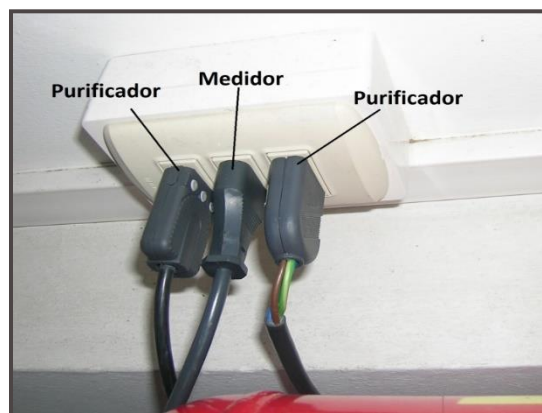
Figura 5.54 Conexión a corriente equipos
