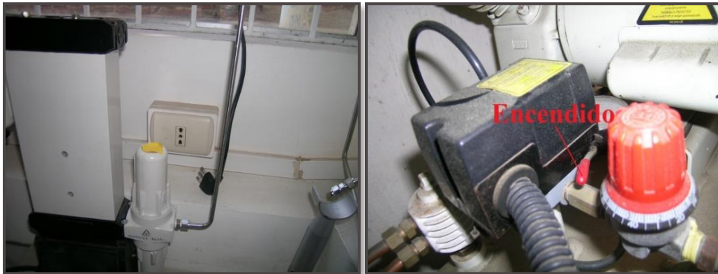
Figura 5.51 Enchufe y encendido compresor C-1.
