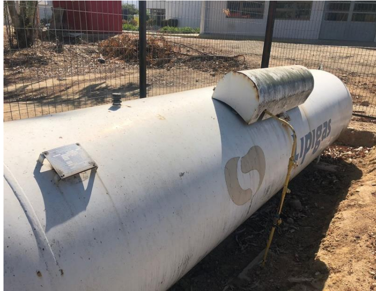
Figura 3.13: Tanque de alimentación de GLP.
