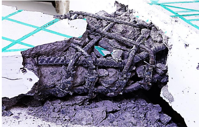
Figura 4. Barras longitudinales pandeadas en dirección perpendicular a la aplicación de la carga (Matson, 2018).
