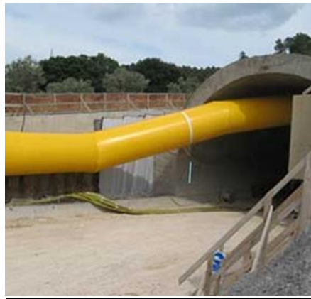
Figura 1.9: Manga de ventilación flexible lisa puesta en la entrada de un túnel.
