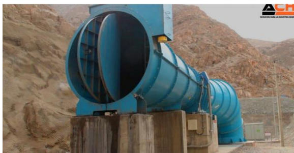
Figura 1.8: Manga de ventilación rígida utilizada al exterior de la mina
