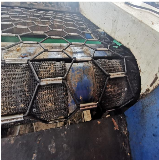
Foto 18: “Separación entre la malla y la plataforma calibre 9 - confección propia”
